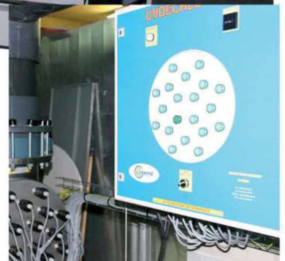
Les déchloramineurs installés à Liberté et aux Ondines.
