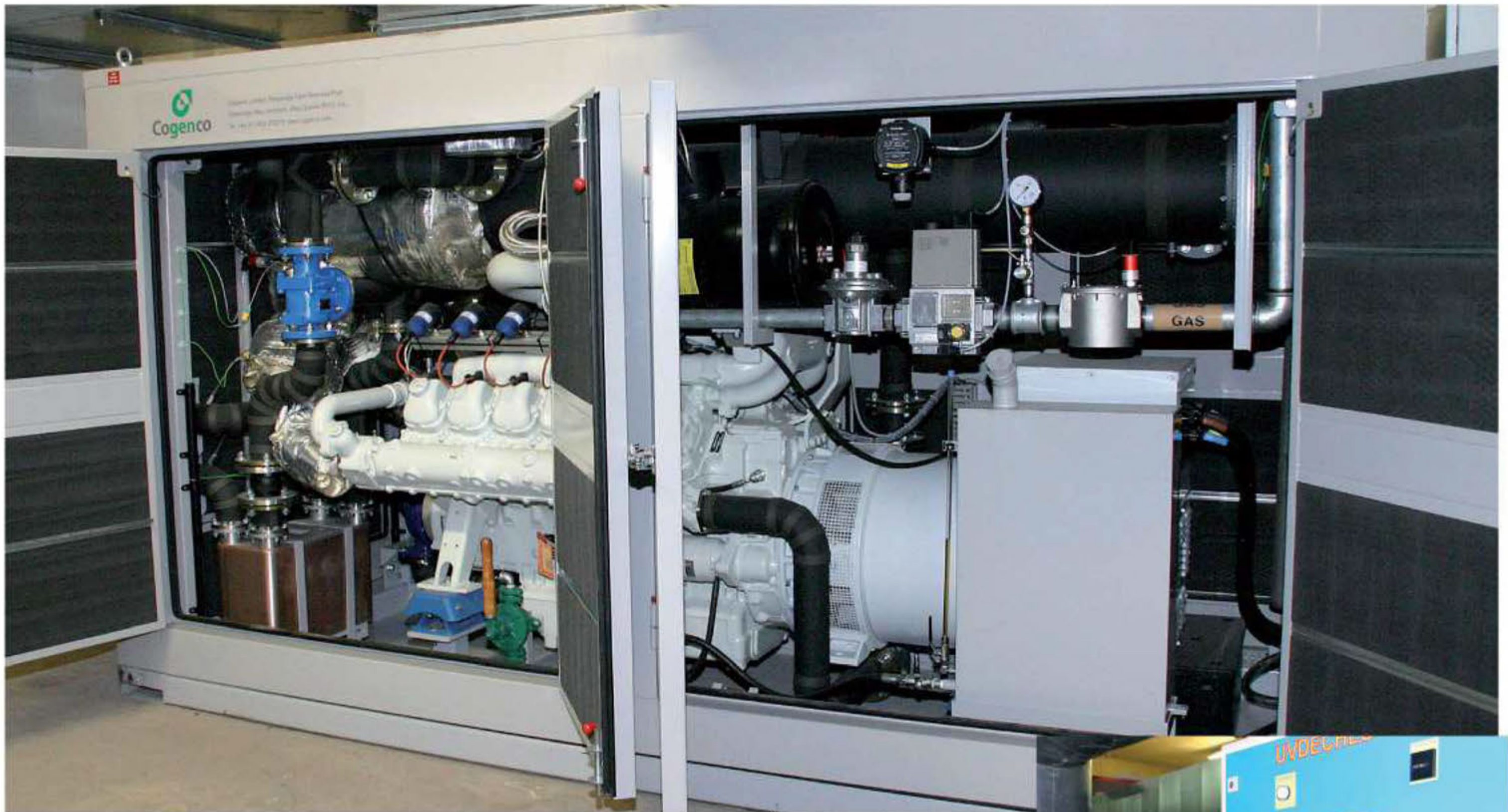
La mini cogénération de la piscine Liberté en fonction.
