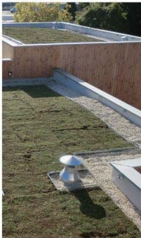
Un toit à couverture végétale pour une meilleure isolation.
